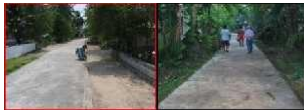
Gambar 5. Keadaan jalan utama dan jalan lingkungan di permukiman
