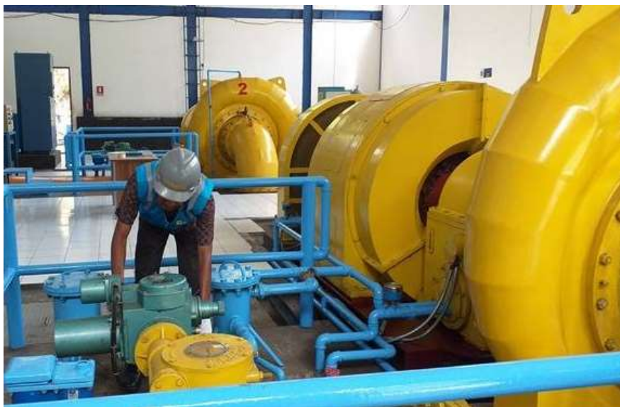
Gambar 3. Turbin dan Generator PLTM Ndungga Ende (Sindonews.com, 2019b)
