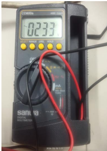
(a) Pengukuran Tegangan Sumber: 233 V AC
